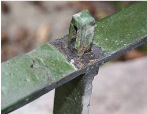
Abb. 7 Im Bild links eine der vier feurgeschweißten Stellen – Indiz für die Vergrößerung des Werks um ein Viertelstundenschlagwerk. Die beiden gehwerksseitigen Bügel in den Kränzen sind eingesteckt und verkeilt und nicht fix vernietet.
